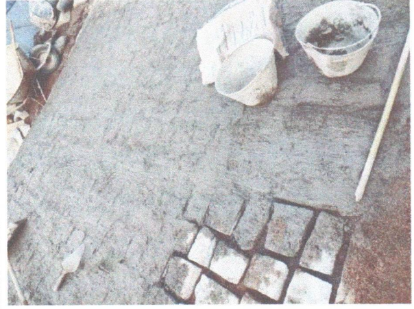
FOTO 2: LADEIRA ZE BUCHUDO - DETALHE DA RE CRAVA;
